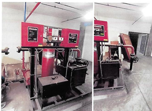
Sistema contra incendio instalado para servicio de la fiscalía, se encuentra operando en buenas condiciones
