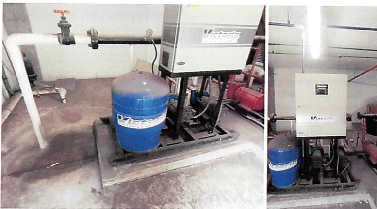
Sistema hidroneumático para servicio de la fiscalía, se encuentra operando en buenas condiciones
