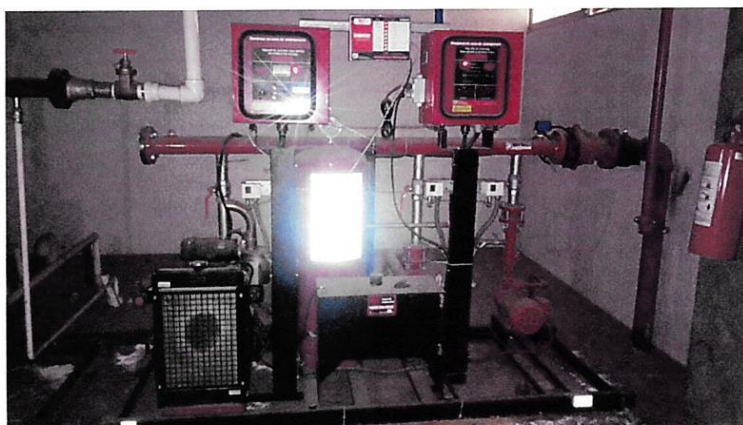
Sistema contra incendio instalado para servicio de Policía de Investigación, se encuentra operando en buenas condiciones.
