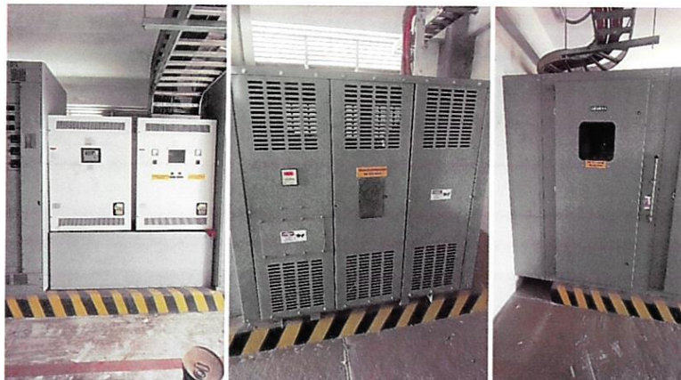
Subestación General, se encuentra en buenas condiciones.
