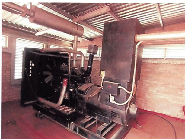
Planta de emergencia instalada, con una capacidad de emergencia de 450 kw la planta se encuentra operando en buenas condiciones.
